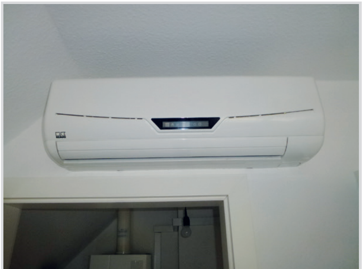
Klimaanlage im Spitzboden
